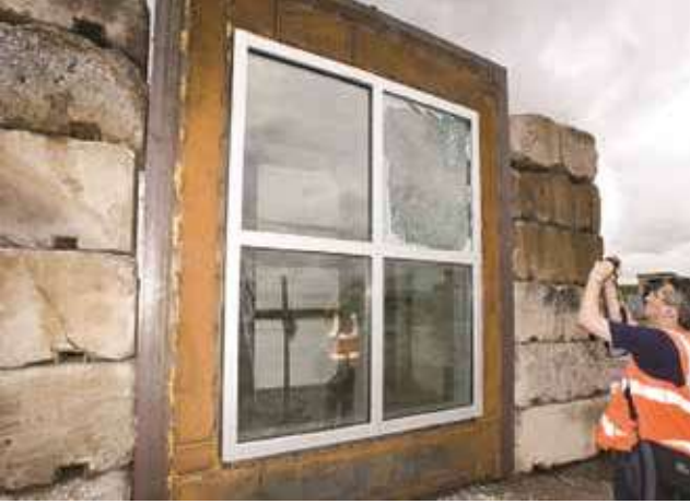
PATLAMADAN SONRA GİYDİRME CEPHE
